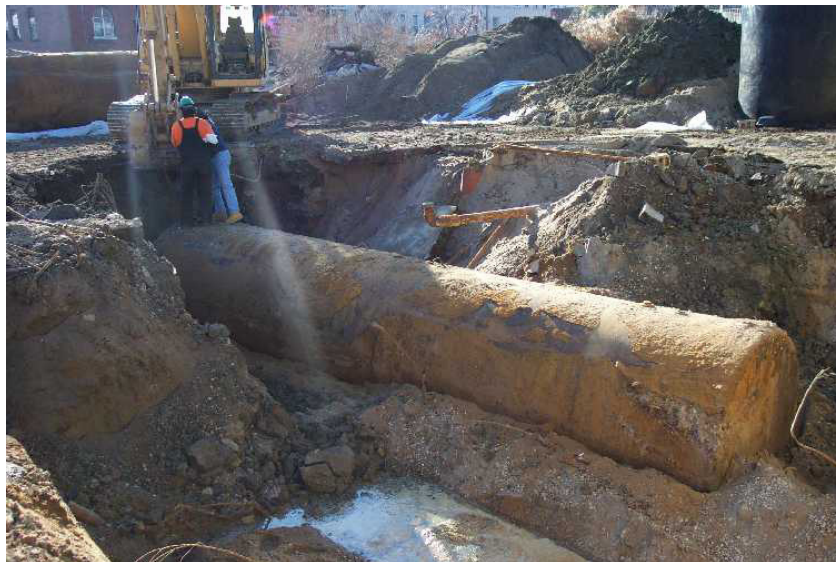
Foto 1.2. Tanque enterrado de almacenamiento de hidrocarburos (UST) en Missouri (EE.UU)
