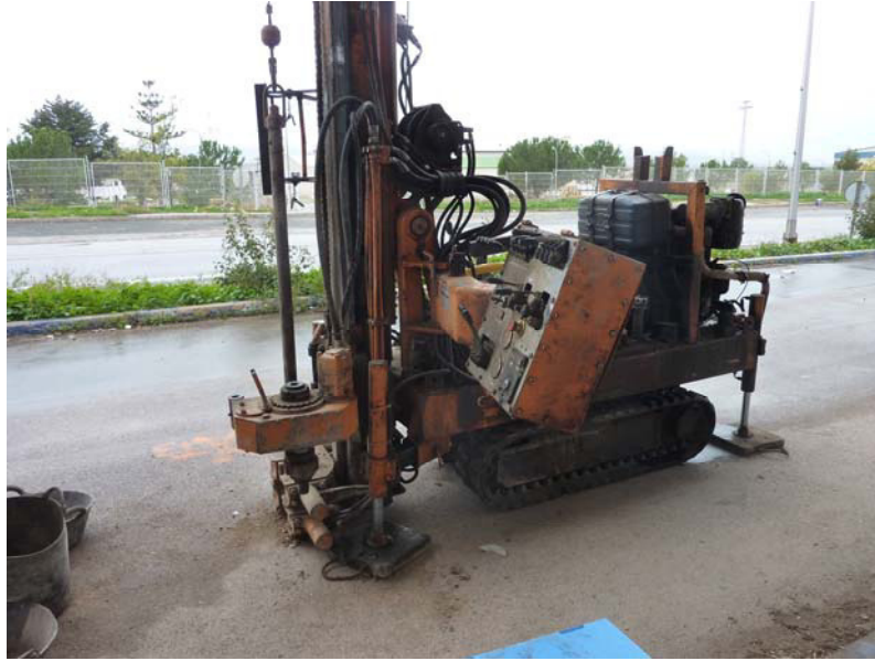
Foto 3.5. Equipo de perforación MAG ESP-25 utilizado para la realización de sondeos y toma de muestras de suelo
